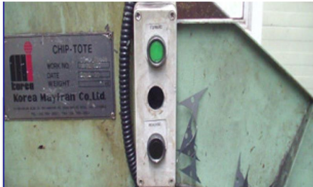
프레스 3호기 컨베이어 비상정지 S/W 버튼 탈락
