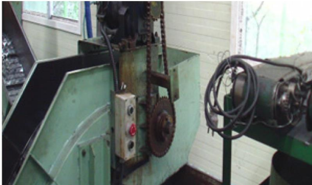
컨베이어 구동체인 방호커버 탈락
